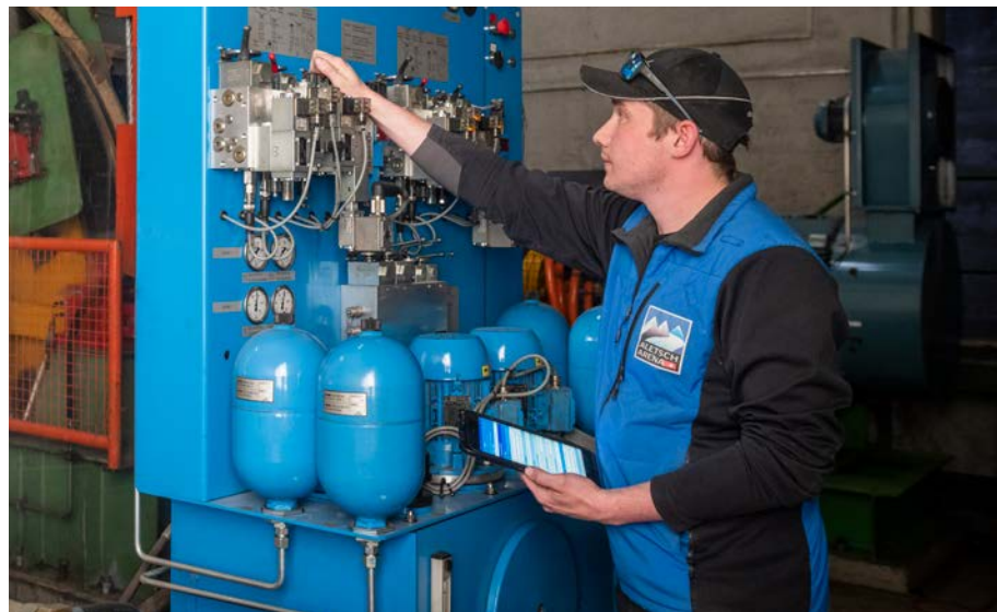
^ Im Maschinenraum prüft Marcel die Ölstände der hydraulischen Bremsen.
