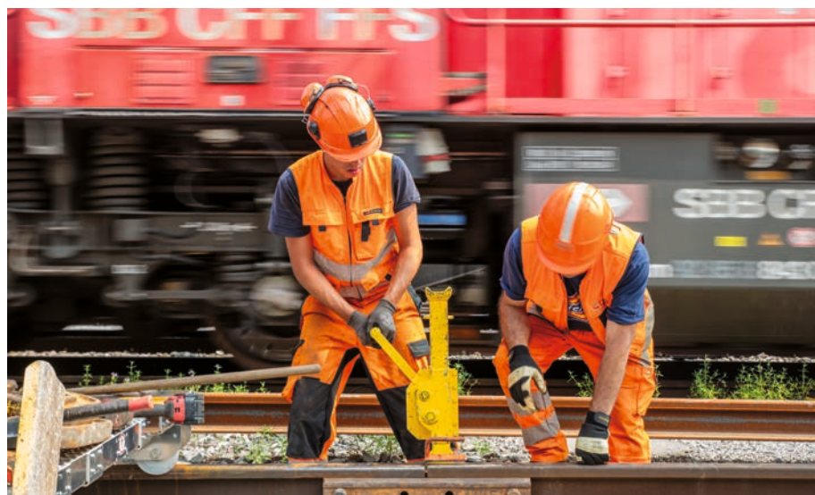
v Malik e il suo collega uniscono due pezzi di binario con una giunzione. Per farlo, sollevano il binario nella posizione corretta utilizzando un verricello a mano.
