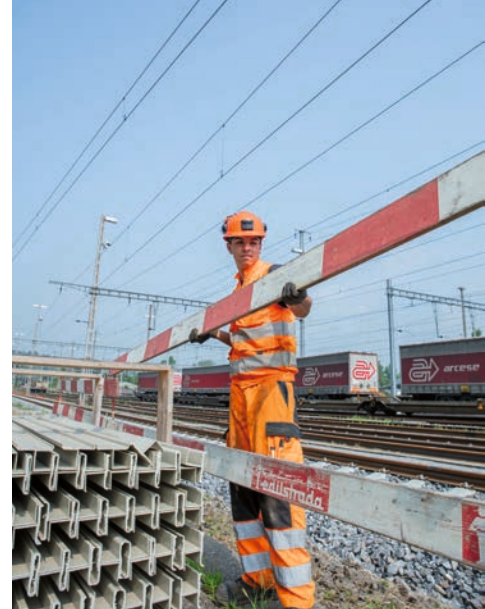
^ Prima dell'inizio dei lavori, il costruttore di binari mette in sicurezza il cantiere con delle barriere.
